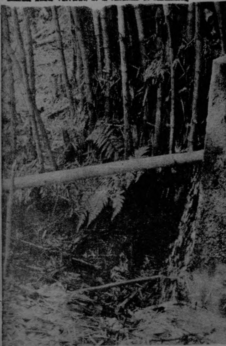
Bajo la sombra de una macolla de bambú surge la tubería de salida por gravedad de las aguas de la fuente de Los Angeles.
